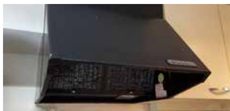
交換されたエアコンと換気扇
